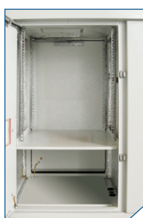
Телеком. отсек Отсек питания
